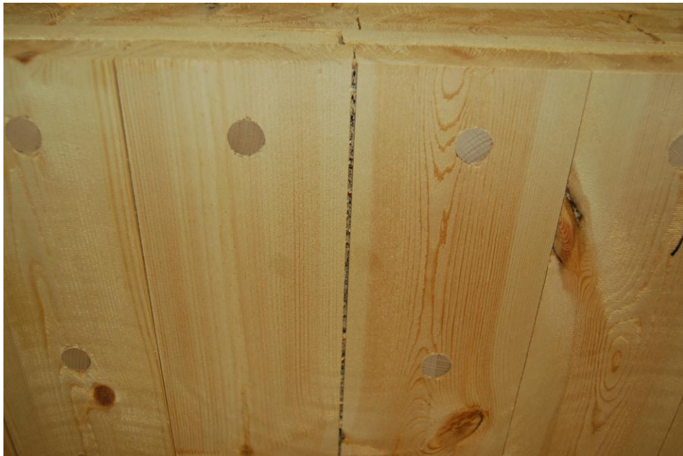
Bilde 7. Store sprekker mellom bord, men ikke innad i bordene.
