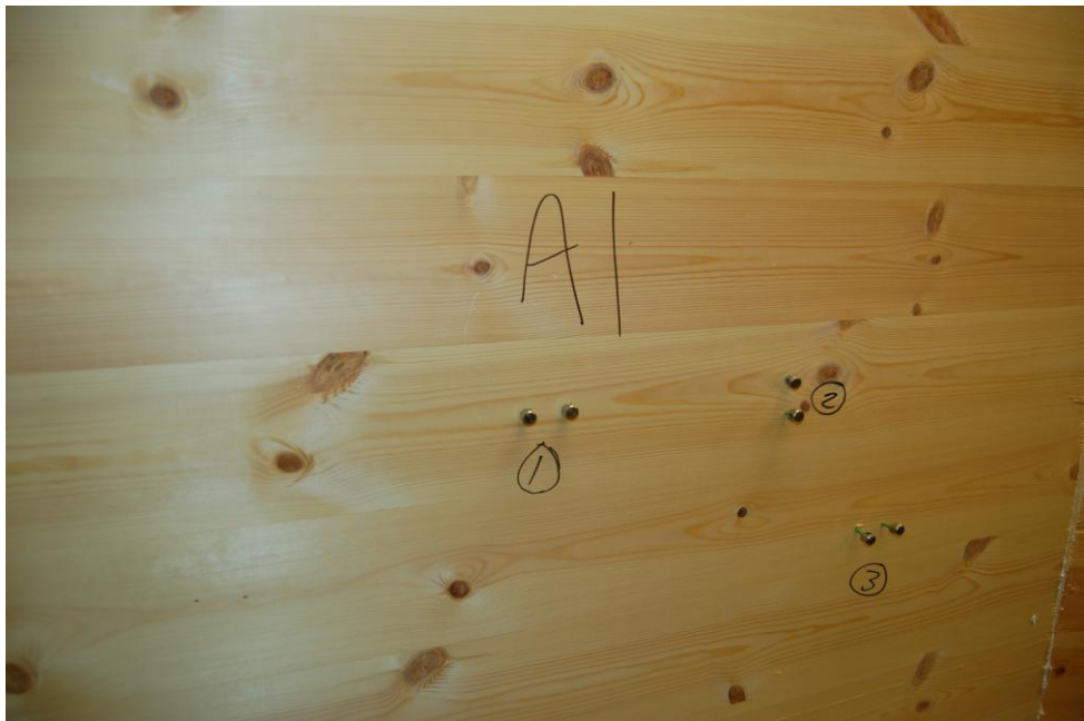
Figur 4. Lite sprekk der fuktigheten er lav i yttersjiktet.
