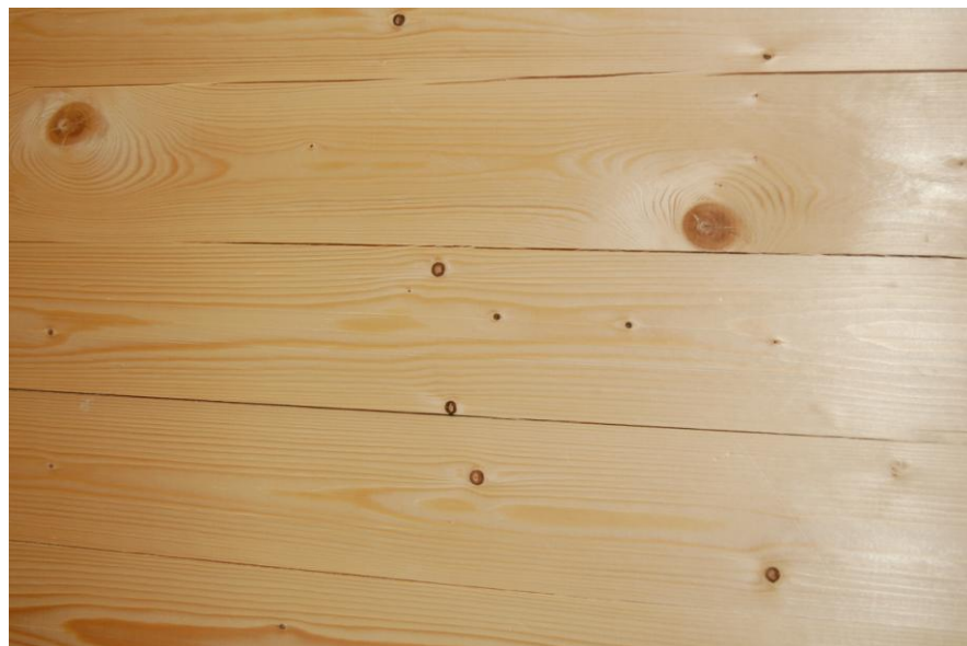
Figur 3. Mye sprekk der fuktigheten i yttersjiktet er høy.
