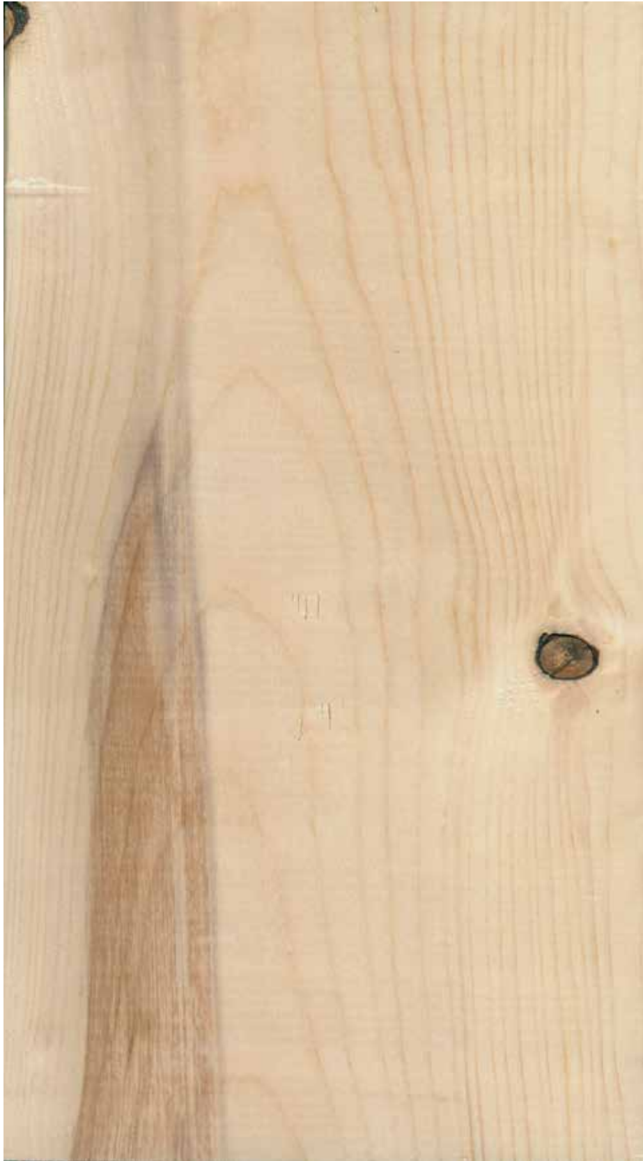
Figur 17. Råte, planken vrakes.
