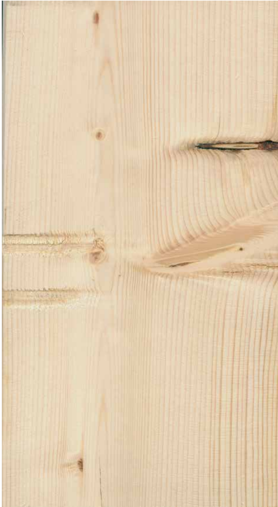
Figur 69. Skader fra medbringer etter hølning. Planken vrakes.
