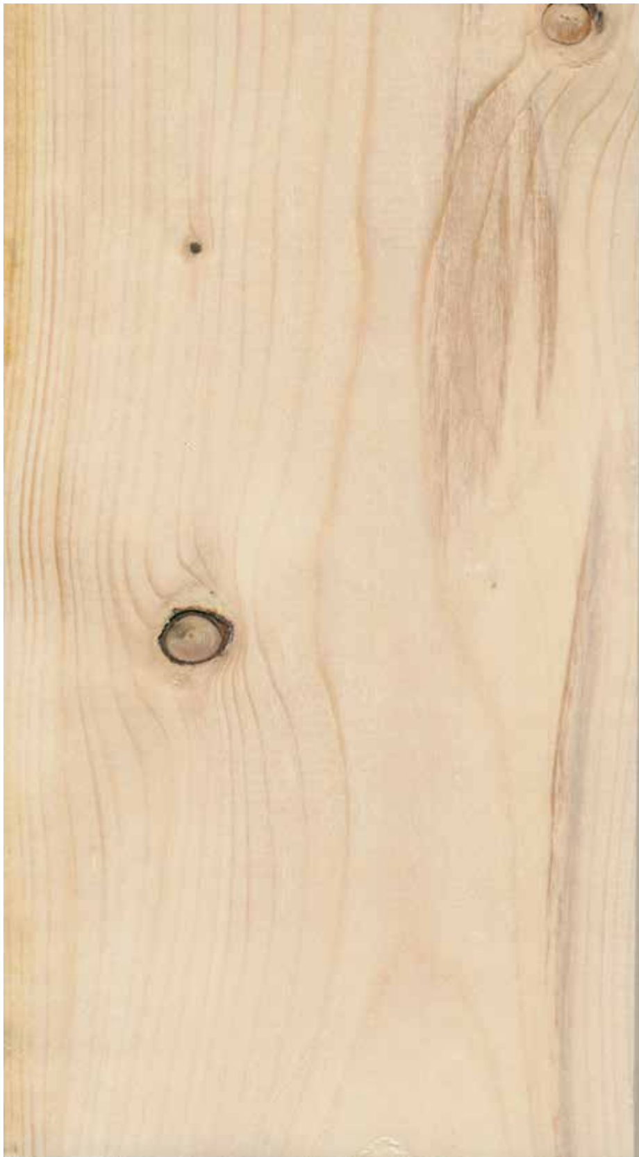
Figur 18. Råte, planken vrakes.
