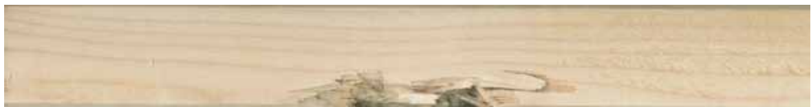
Figur 76. Skade på kant. Planken vrakes.
