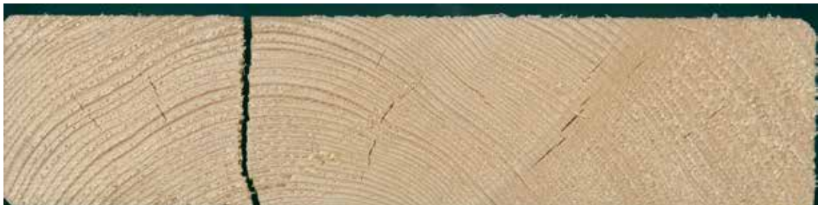
Figur 83. Gjennomgående sprekk er kun tillatt i enden av planken i en lengde lik virkesbredden, men maksimalt 150 mm.
