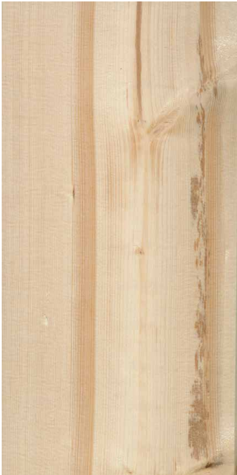
Figur 23. Råte til høyre, planken vrakes.
