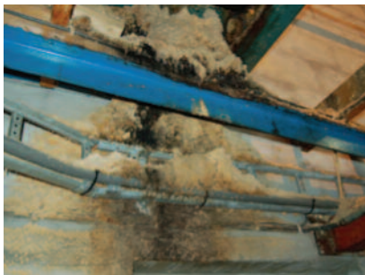
Dette er en meget uheldig blanding av elektrisitet, olje og flis.
