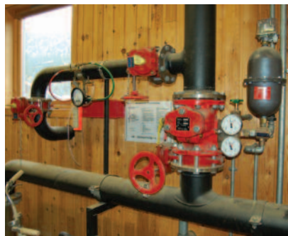
Husk regelmessig kontroll av sprinkleranlegg.
