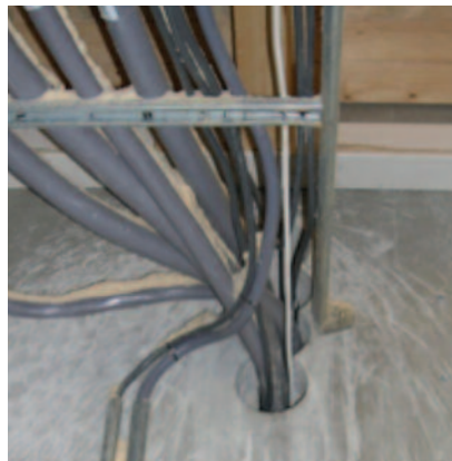
Slike gjennomføringer i et brann-teknisk skille må tettes med godkjent brannhemmende materiale.
