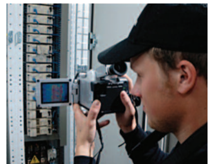
Termografering er en god metode for å oppdage unormal høy temperatur i et tavleskap.
