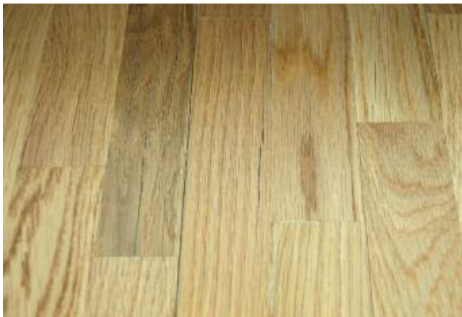
Bildet viser en flersjiktsparkett der slitelaget av eik har fått store sprekker både mellom og innad i brettet, da den ikke har tålt det tørre klimaet den ligger i.
