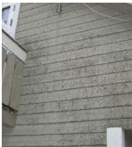
Svertesopp oppfattes som veldig stygt, men det er få som kjenner tiltak for å unngå slike fasader. Bilde: Mycoteam.
