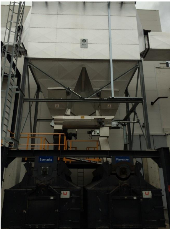
Figur 5: Mellomlagring av aske ved et moderne biobrenselanlegg hvor flyve- og bunnaske har hver sin konteiner.
