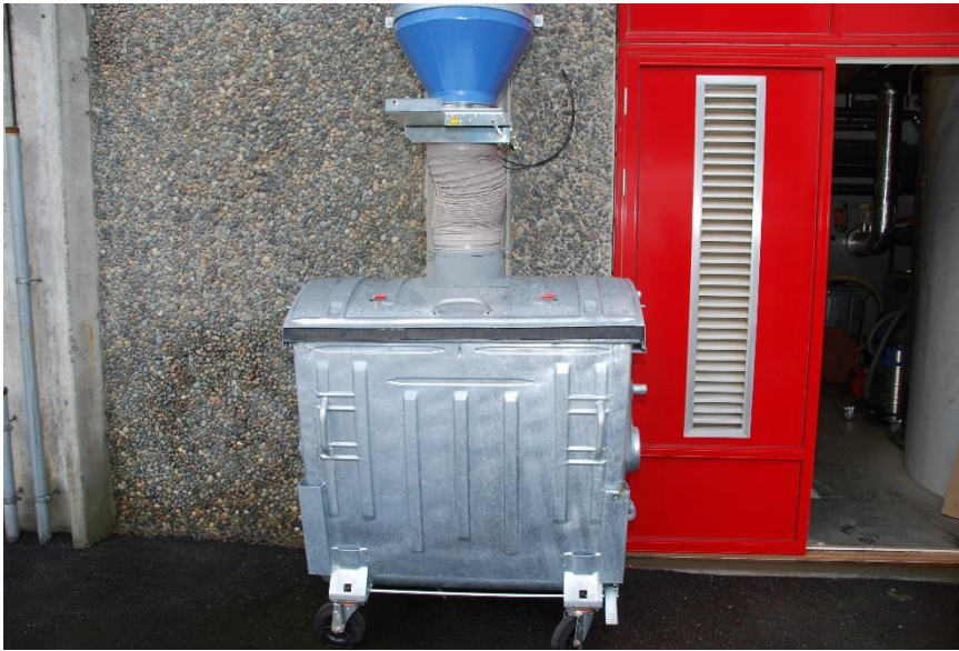
Figur 6: Mellomlagring av aske fra et moderne mindre anlegg for flisforbrenning i trevareindustrien.
