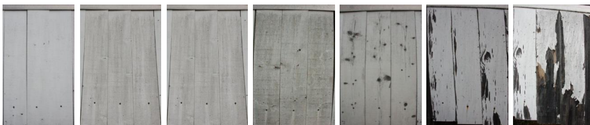
Figur 4. Kledning med i ulike stadier av nedbryting, bildene er tatt på Treteknisk sitt forsøksfelt i Sørkedalen. (Foto: Treteknisk).
