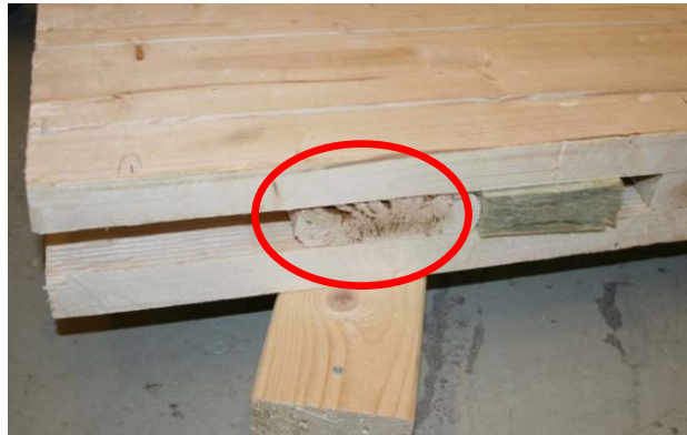
Figur 17. Prøve nr. 1: Det ble også observert råte i en tverrlamell.
