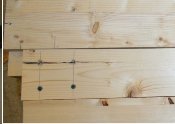
Figur 28. Prøve nr. 1: Nærbilde av oppsprekking mellom skruer på rekke og helt ut til kant.
