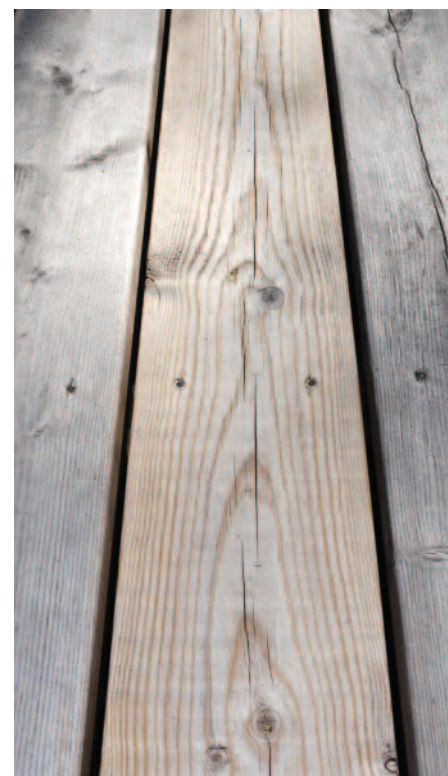
Bilde 7. Kopperimpregnert furu med få, men lange og brede sprekker.
