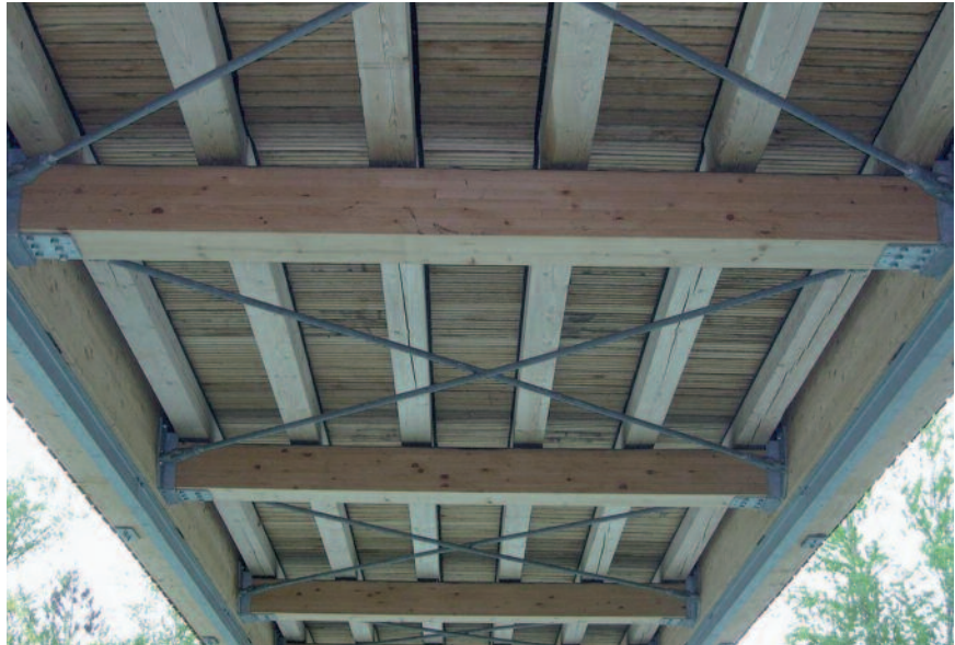
Bjelkebro med sekundærsystem og avstivingsystem.
